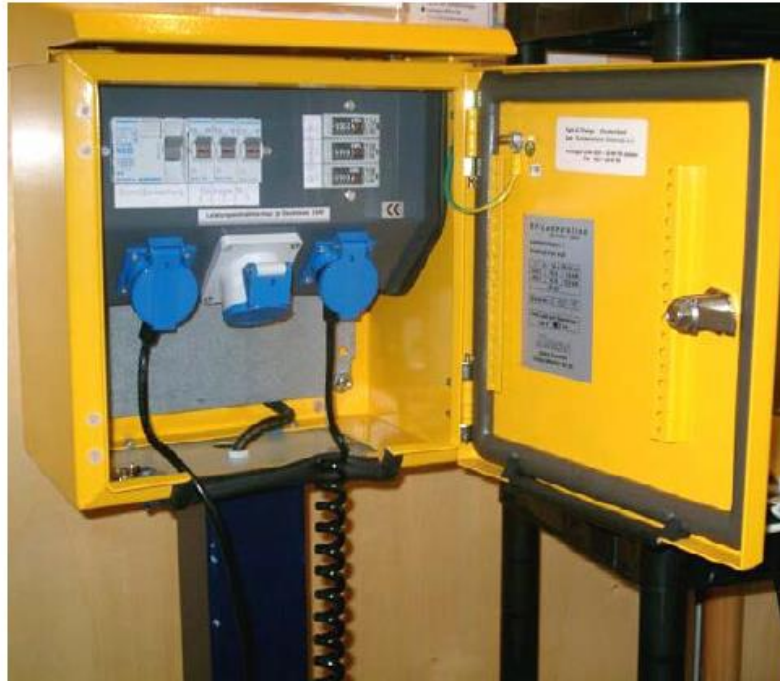
Slika 10. Priključni ormar za punjenje prema Mod 2 načinu [1] S lijeva na desno: obična 10-16 A 250 V utičnica, CEE 16 A, 250 V, CEE 16 A, 400 V
